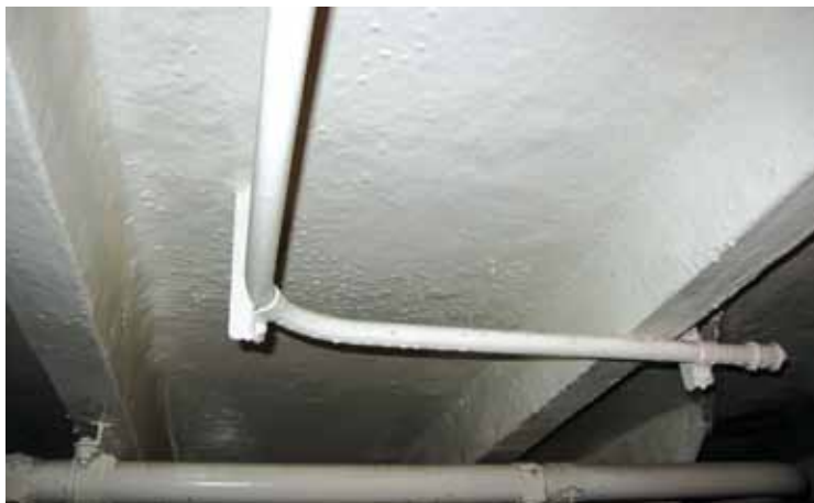
Skibsløft med sprøjteasbest og glat malingsforseglet overflade.
